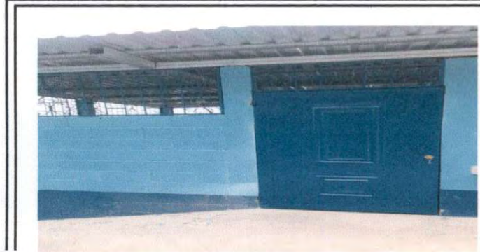
Foto 1: Sustrución de puerta de metal en cocina.
