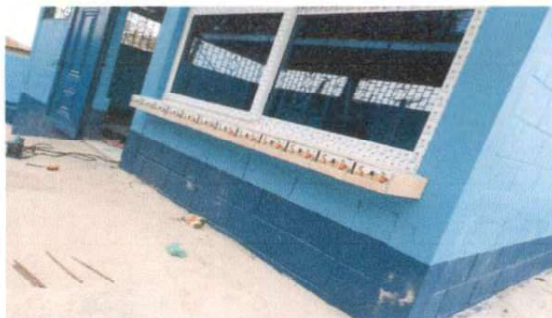
Foto 7: Sustrucción de estructura de metal por ventana en la cocina
